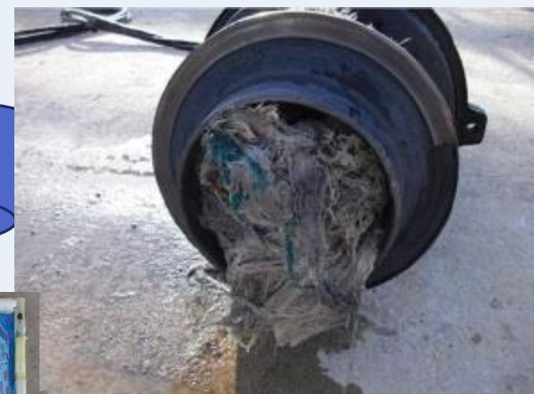
Fuente: Consorcio de Aguas Bilbao Bizkaia
